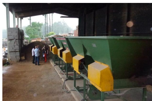
Figura 4 – Alimentação automática em forno eficiente tipo vagão em cerâmica de São José dos Pinhais.
